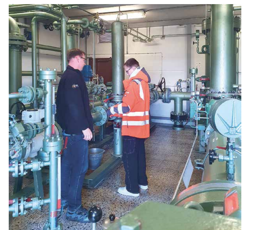
Theo und Christian Branzke, Sachgebietsleiter Gas/Wärme bei der SÜW, in der Gasdruckregelanlage.
